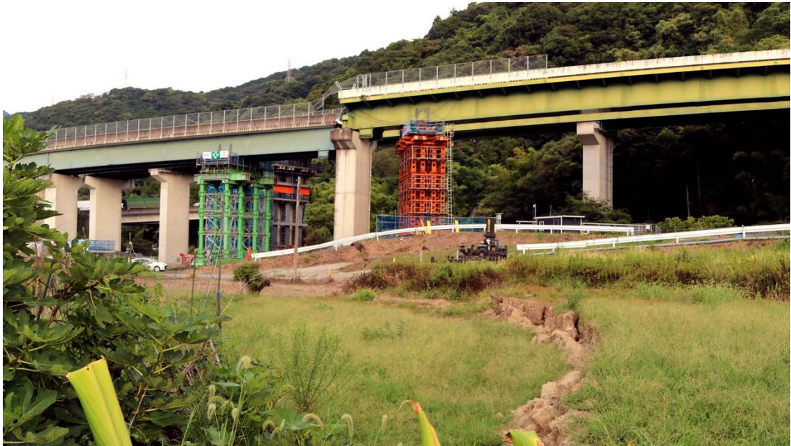
写真2. 八代ジャンクション付近に出現した地表地震断層。地震断層は写真右手前から中央奥に向かって連続し、橋脚の下を通過している。[岡田真介撮影]
