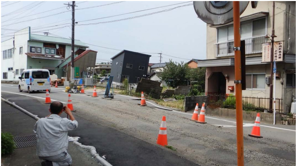
写真 7. 宇城市小川町小川付近の地表地震断層による道路および住宅地の被害。地表地震断層は、写真手前から左奥の黒壁の住宅の方向へ地震断層が連続する。道路面やフェンスも大きく変形している様子が見られる。[山本英和准教授撮影]
