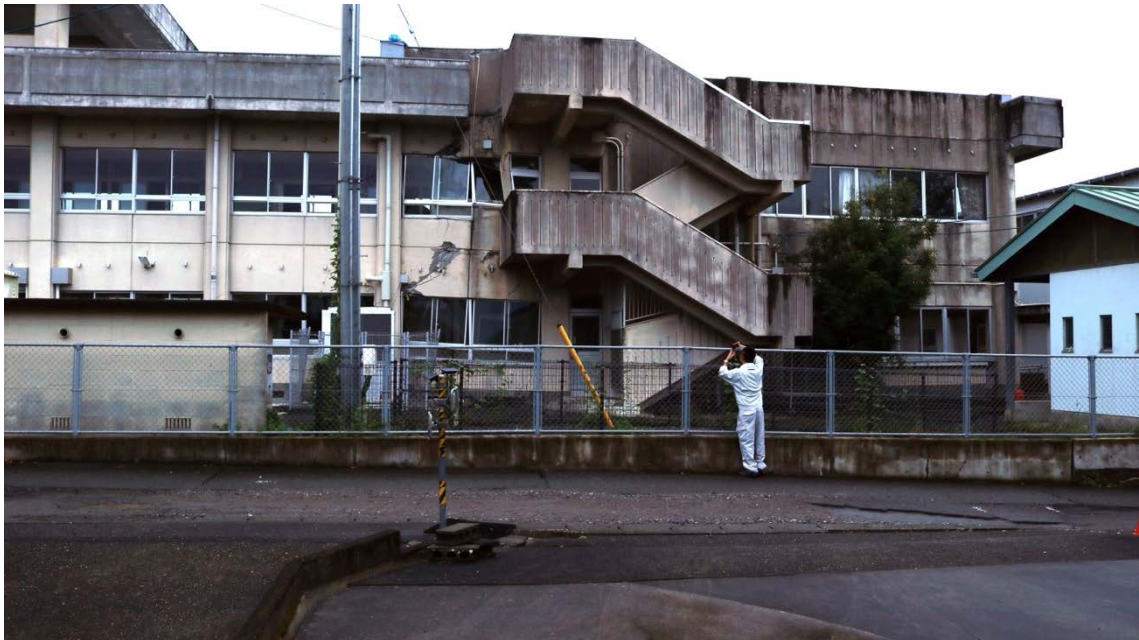
写真 5. 龍峯小学校の校舎下を通る地表地震断層。画面中央部分の窓枠が大きく破壊されている。写真中央の手前から奥に向かって、地震断層が通っており、校舎の奥側のグラウンドに連続する。地震断層による地盤変位により、校舎に破壊が生じた。[岡田真介撮影]
