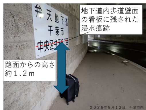
弁天地下道歩道壁面看板の浸水痕跡
