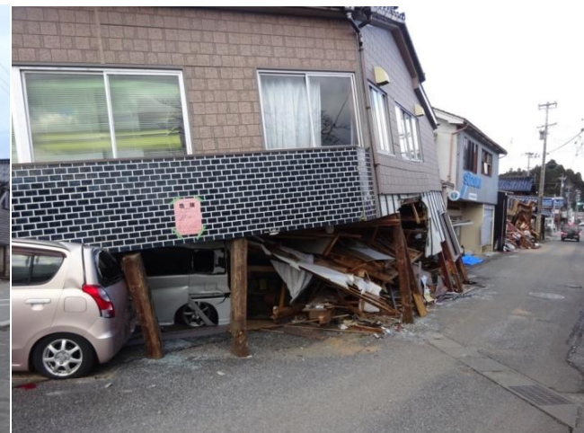
写真6. 地震による木造建築物の倒壊
