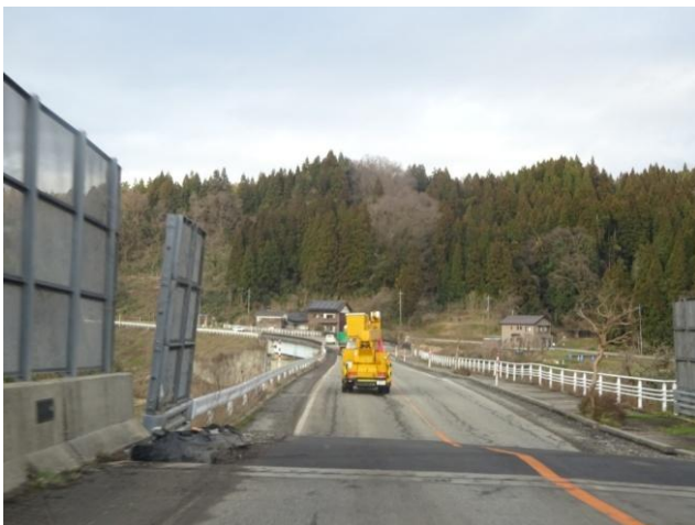
写真1. 橋梁部分における段差の発生
