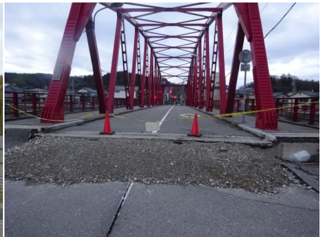
写真2. 橋梁部分における段差の発生
