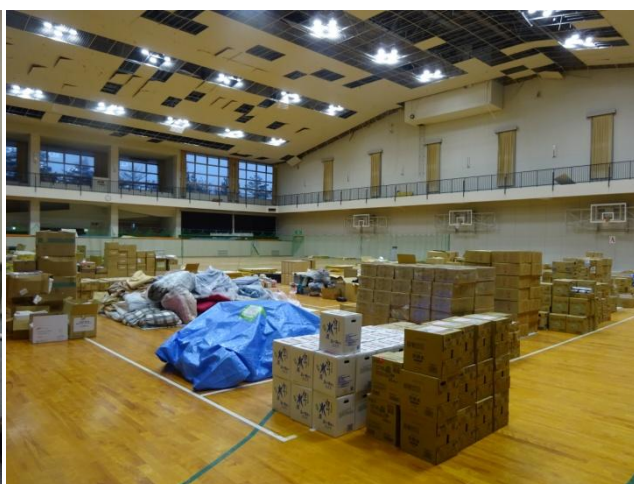
写真10. 地震により天井パネルが落下した体育館
