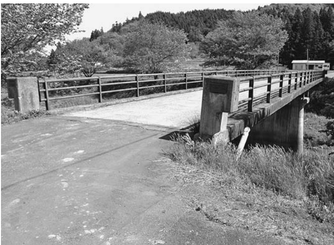
修繕へ設計を進める広瀬大橋
