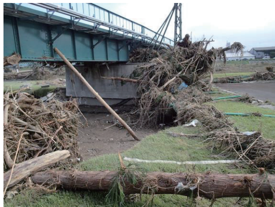
写真-1 久慈川鉄道橋の流木堆積 (2016 年 9 月 2 日撮影)
