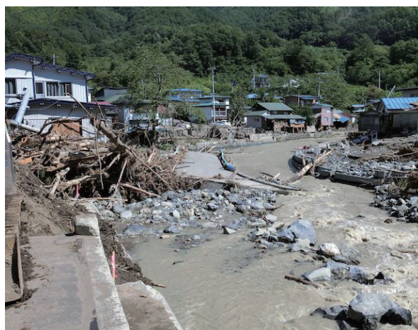
写真-1 岩泉町を流れる小本川で橋脚が流された被害状況
