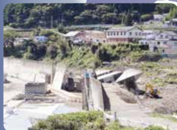
津波により破壊された唐丹湾小白浜漁港の防潮堤
