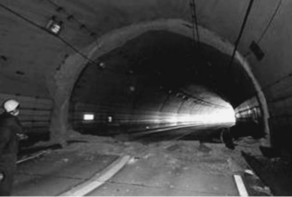
れ 2 覆工コンクリートの崩落と盤ぶく
